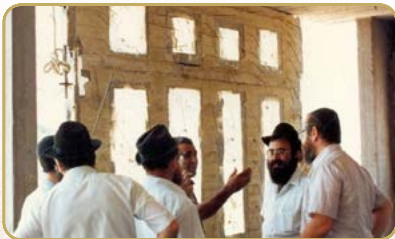
יו"ר ועד כפר חב"ד ר' מנחם לרר משוחח עם חסידים ובעלי מלאכה בבניין
